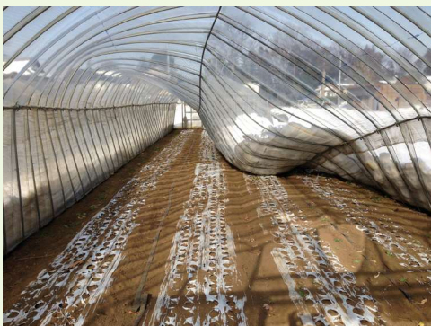
図1 積雪による施設の倒壊(2014年)
